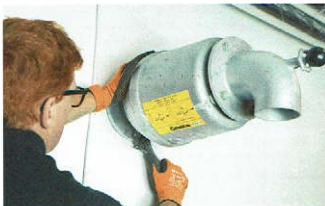
Montering av stötvågsventil.
