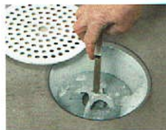
Se till att golvbrunnarna i skyddsrummet är stängda.
