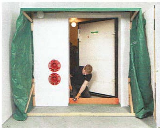
En monterbar luftsluss (även kallat gasfång) under iordningställande.
